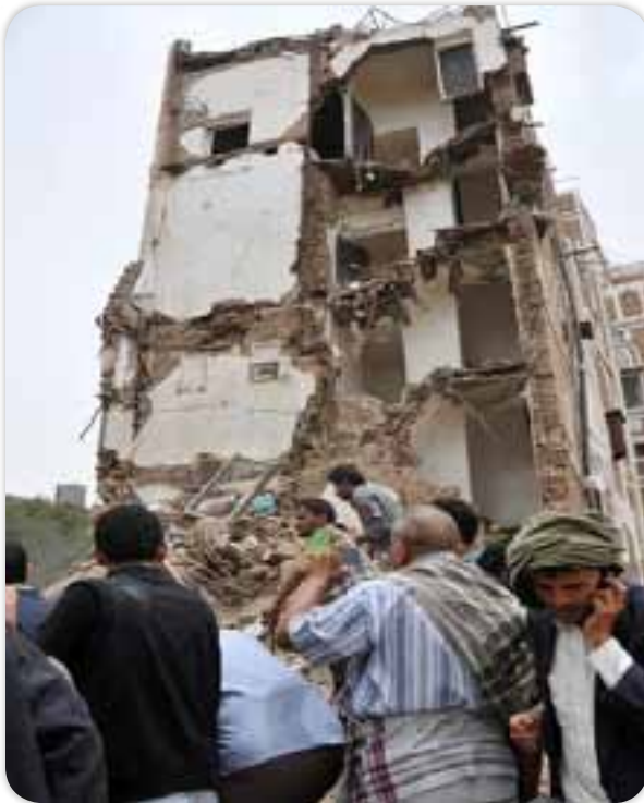
آثار الدمار على منزل أحد المواطنين في صنعاء القديمة نتيجة قصف طيران تحالف دول العدوان
